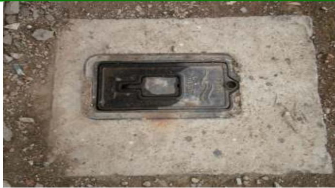
Medidor de Interagua – Ubicado en las viviendas de Horizontes del Guerrero.
